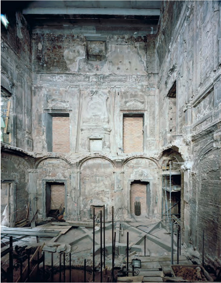
Raum der völlig zerstörten Englischen Treppe
